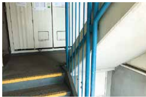
落下防止柵のみで、手すりが今後付くこととなります
