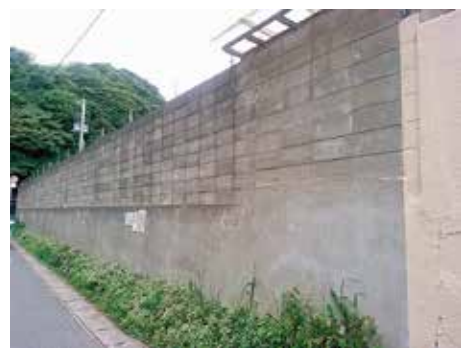
建築基準法に「不適合」とされた市内の学校のブロック塀
